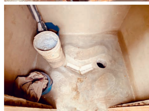
Ein Foto vom Innenraum einer Trockentrenntoilette zu zeigen, ist nicht „sexy“, aber sinnvoll. Denn es zeigt anschaulich, wie Urin und Feststoff getrennt werden. Durch das Hinzufügen von Asche und Sand (in den beiden Säcken links) werden unangenehme Gerüche gebunden und die Qualität des Komposts erhöht.
