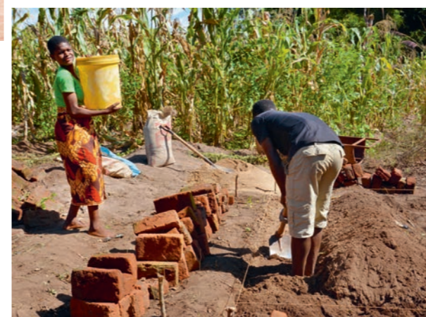
Wie bei allen DESWOS-Projekten leisten die Familien eine hohe Eigenbeteiligung, wie hier etwa in Form von Hilfsarbeiten auf der Baustelle.
